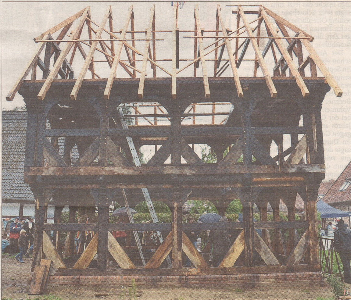
Der ehemalige Hopfenspeicher vom Hof Heinrich Bätke erlebt an der Hagenstraße sein zweites Richtfest (großes Bild und kleines Bild rechts). Ansgar und Meike Heise (kleines Bild links) wollen das geschichtsträchtige Gebäude an der neuen Stelle einer neuen Verwendung zuführen. Zimmer (3)
